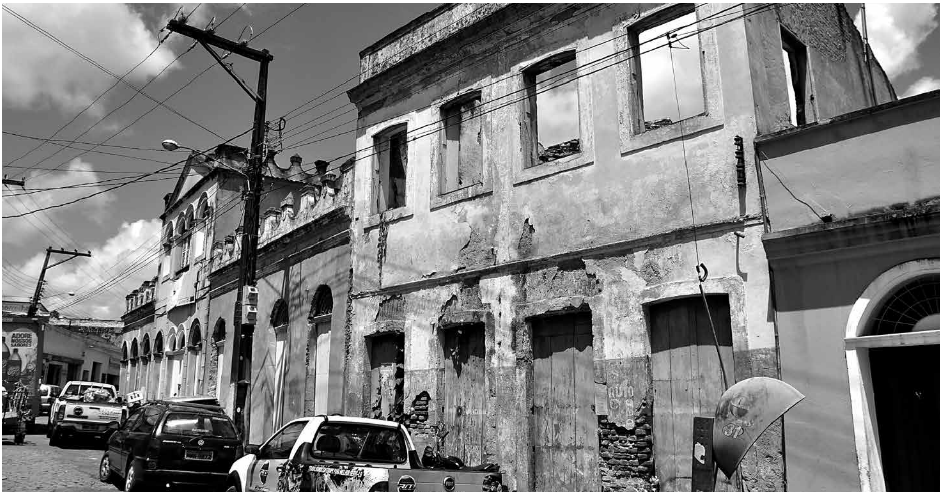
Cerca de 900 imóveis são tombados pelo Iphan, mas apenas 380 estão aptos ao financiamento; Defesa Civil Municipal afirma que 83 prédios estão sob risco
